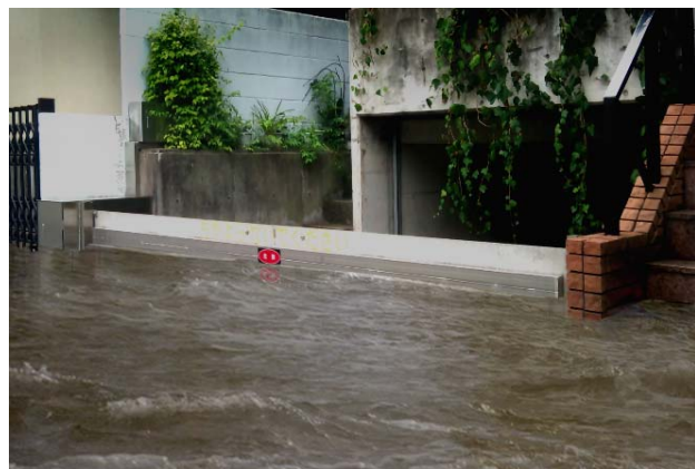
<地下駐車場への浸水を防ぐ止水板事例>
